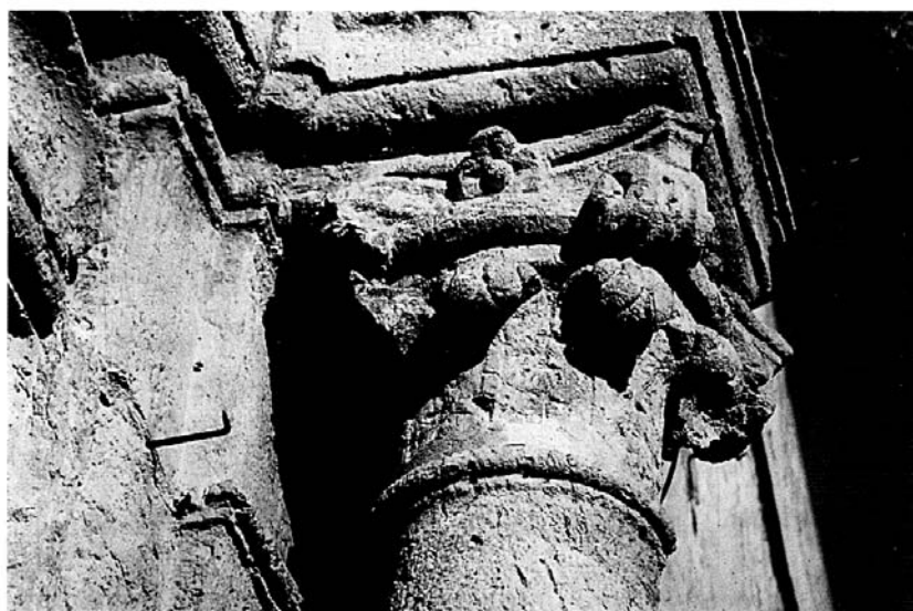
Fig. 4 - Mandanici. Chiesa Madre: porzione sommitale di una delle colonne frontali del prospetto. L'estrema eterogeneità del materiale è la principale causa dei fenomeni di distacco e scagliatura osservati.
