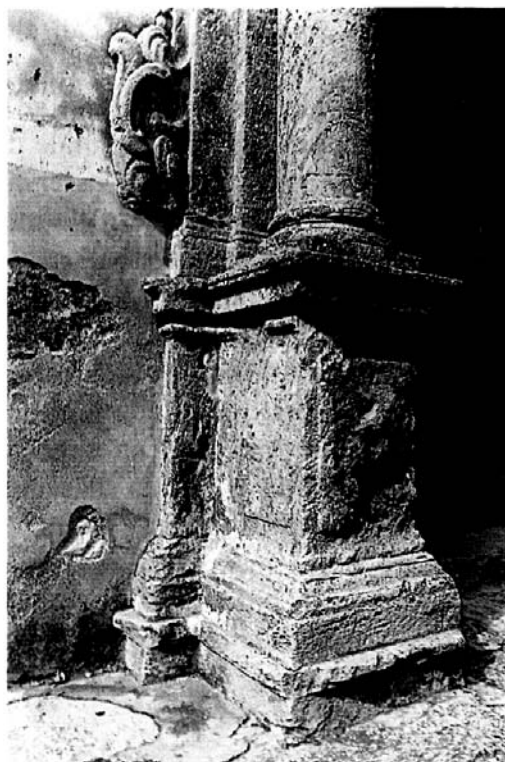
Fig. 3 - Mandanici. Chiesa Madre: porzione basale di una delle due colonne del portale con evidenti fenomeni di degrado.
